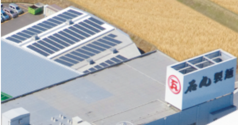
太陽光パネル
